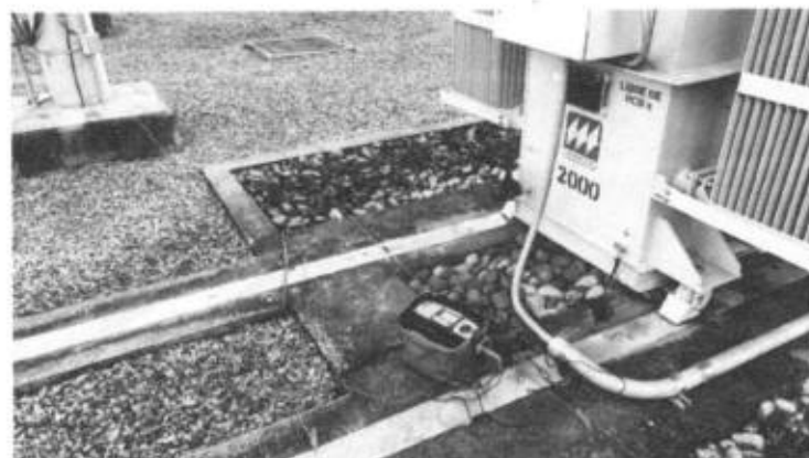
Imagen 1: Registro fotográfico del Transformador de 2000KVA
